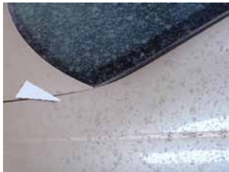
Niet acceptabel (chemie-inwerking; zichtbare aantasting)
