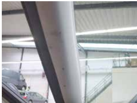
Niet acceptabel (brandplekjes raamstijl)
