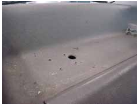
Niet acceptabel (doorvoergaten voor kabels)
